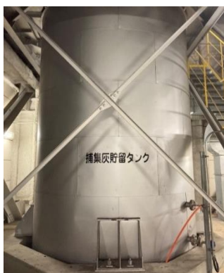
写真－1 捕集灰貯留タンク
