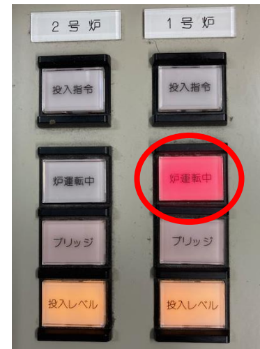
写真-5 操作室パネル
