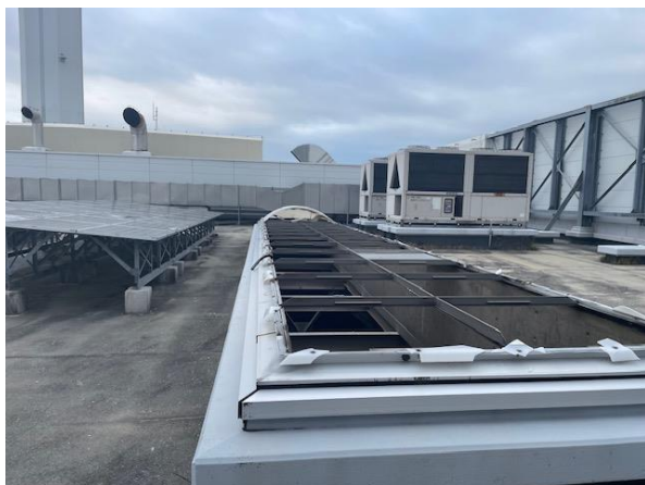
写真－５ トップライト被害状況
