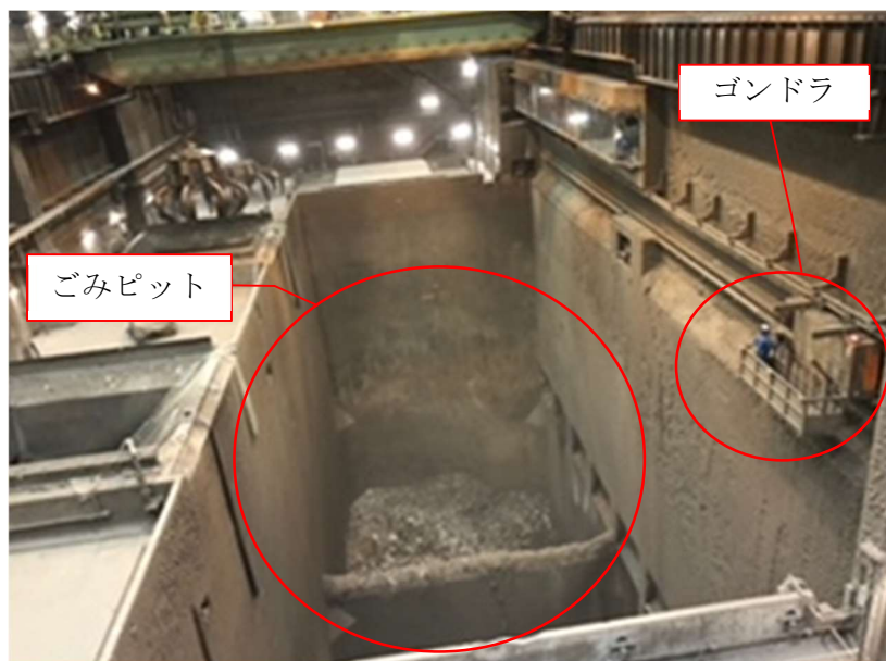
写真－1 ごみピットとゴンドラ
