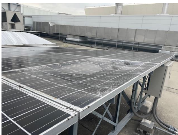
写真－７ 太陽光パネル被害状況
