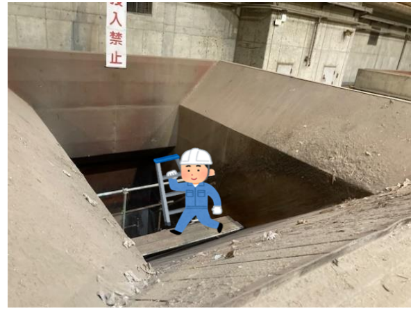
写真-3 ホップ内の作業員に気づかない状況
