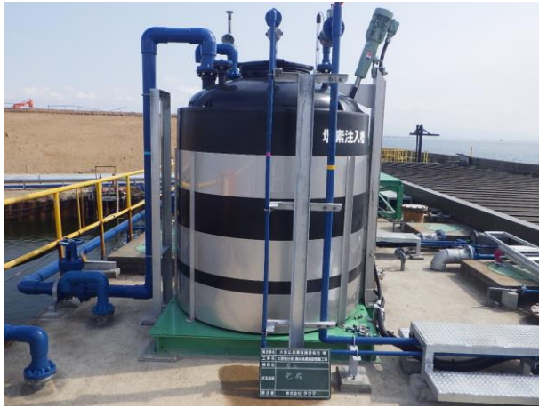
写真－3 塩素注入槽整備状況
