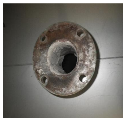
写真-4 フランジ開放部
