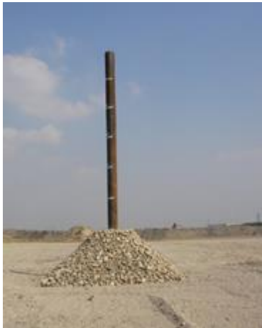
写真－1 ガス抜装置写真
