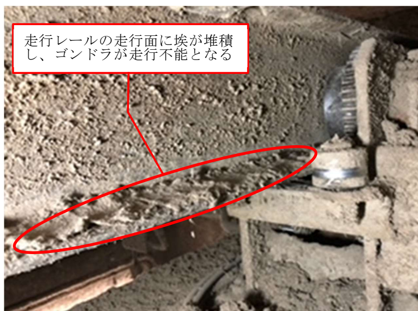
写真－4 走行レール拡大写真
