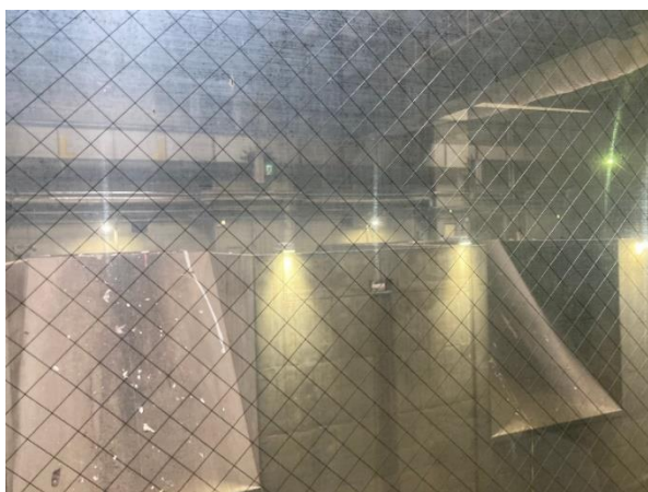
写真-9 ごみピット仮設照明
