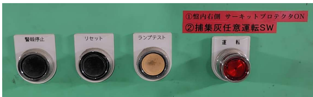
写真-1 捕集灰貯留槽制御盤表面の専用スイッチ
