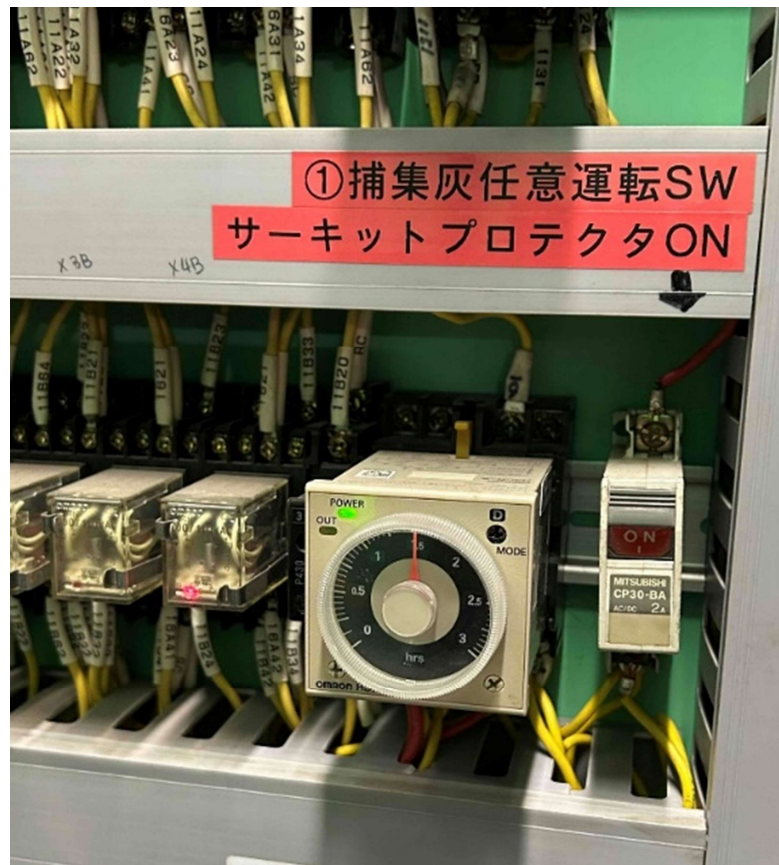
写真－２ 捕集灰貯留槽制御盤内のタイマ
