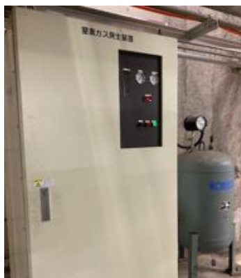
写真－8 窒素ガス発生装置
