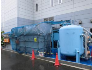
【参考】除染水処理装置
